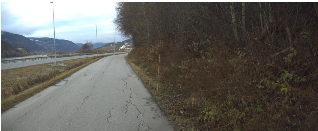
Bilde 5: Kv 20201, hp.2, km 1,480 (6.11.2013) – langsgående telesprekker og deformasjoner
