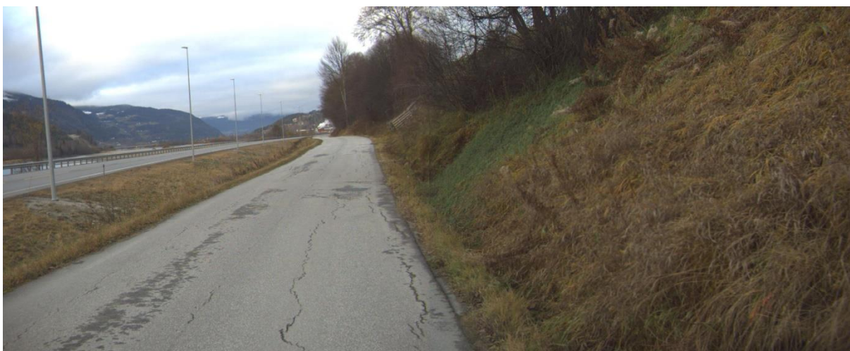
Bilde 4: Kv 20201, hp.2, km 1,320 (6.11.2013) – langsgående telesprekker og deformasjoner
