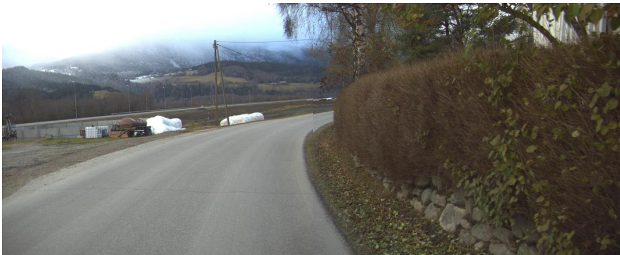
Bilde 2: Kv 20201, hp.2, km 0,370 (6.11.2013) - temperatursprekk
