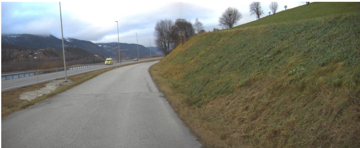
Bilde 3: Kv 20201, hp.2, km 1,230 (6.11.2013) – dekkeskjøt med andre skadetyper nordover
